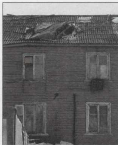
Провал дымохода на крыше деревянного дома в с.Тиличиха.
