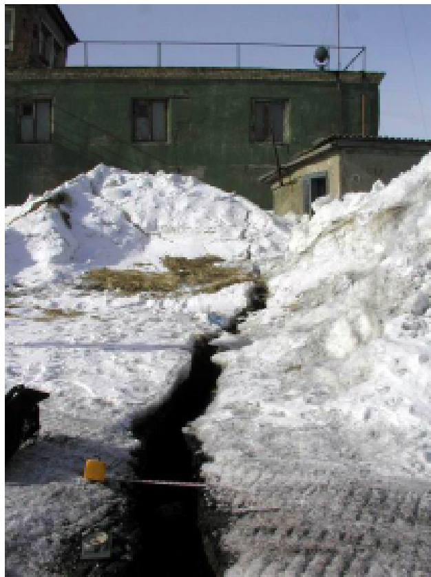
Рис. 8. Трещина в грунте, проходящая через фундамент и стену в бетонном здании, пос. Корф.
