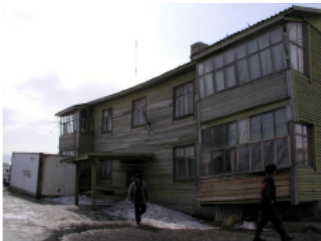
Рис. 6. Перекошенный деревянный дом в результате просадки грунта под фундаментом, с. Тилички.
