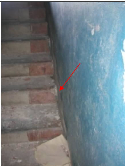
Рис. 4 д. Зазор между внутренней стеной и лестницей с 1-го на 2-ой этаж в бетонном 4-этажном здании (№19 на рис. 2).
