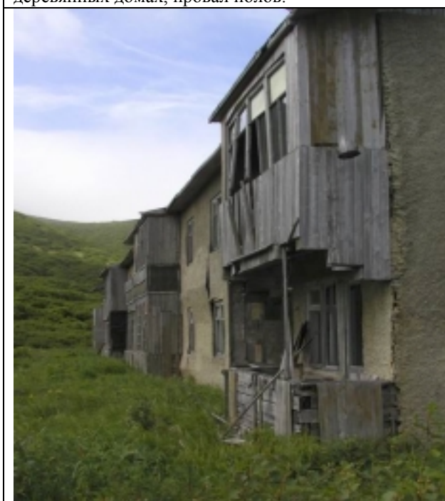
Рис. 3, ш, щ. Трещины, деформации и обрушение армированных цементно-бетонных «рубашек» в деревянных зданиях.
