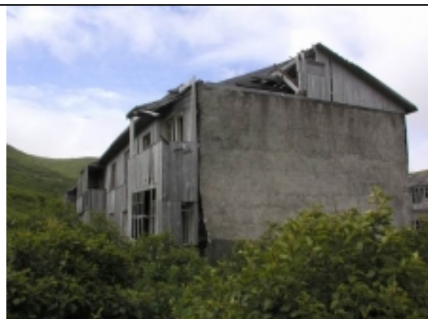
Рис. 3 о. Частичное обрушение крыши деревянного дома (вероятно из-за ветхости) (№ 15 на рис.2).
