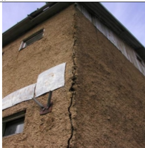
Рис. 3 с, ф. Сквозная трещина в армированной цементно-бетонной рубашке деревянного дома (№ 10 на рис.2)
