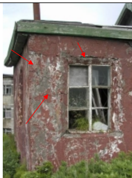
Рис. 4 б. Трещины в бетонном одноэтажном здании (№ 6 на рис.2).
