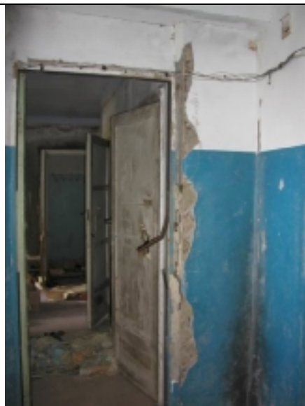
Рис. 4 ж. Осыпание штукатурки и трещины вдоль дверных проемов в 3-х этажном бетонном здании (№ 18 на рис. 2).
