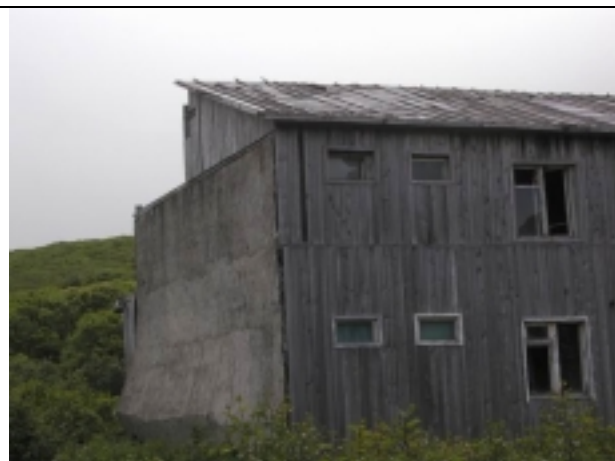
Рис. 3 н. Отход цементно-бетонной армированной рубашки от деревянной стены дома (№ 15 на рис. 2).
