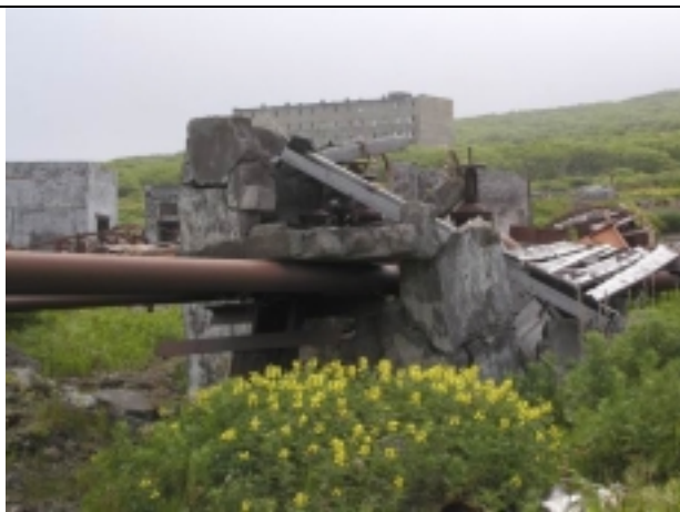
Рис 5 д. Разрушение шлакоблочных переходов над наземными трубопроводами.
