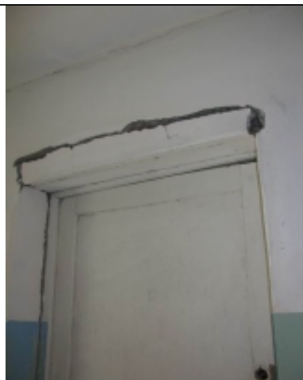
Рис. 4 г. Трещины в дверных проемах (№18 на рис. 2)
