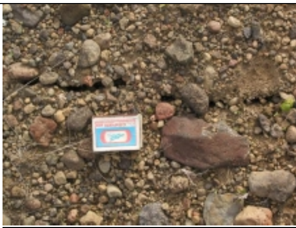
Рис 5 г. В насыпных грунтах обнаружены единичные сейсмовибрационные трещины шириной до нескольких см.
