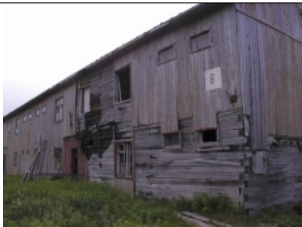
Рис. 3 л. Деформация стен в деревянном доме по адресу Коммунистическая 6 (№ 13 на рис.2).
