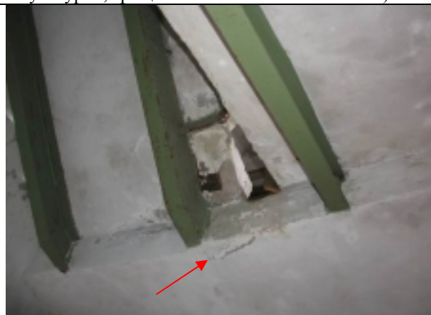
Рис. 4 у. Небольшие трещины на линии стыка лестничных проемов с ж/б перекрытиями.
