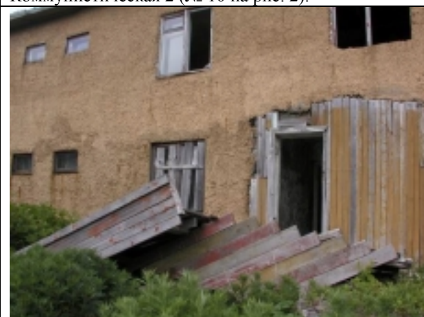
Рис. 3 в. Крыльцо дома (№ 10 на рис. 2), упавшее в СЗ направлении вероятно во время землетрясения.
