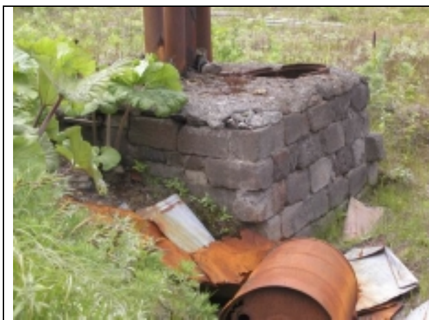
Рис 5 ж. Шлакоблочные опоры под трубопроводы.
