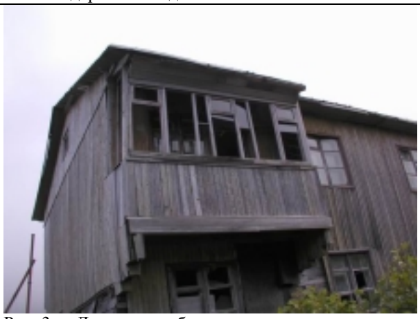
Рис. 3 м. Деревянные балконы как правило не обрушены, но покороблены и отошли от стен домов (№ 14 на рис.2).
