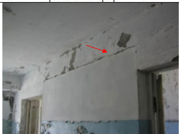
Рис. 4 х, ц. Внутри этого же здания местами обвалилась штукатурка, образовались трещины по стыкам бетонных панелей.
