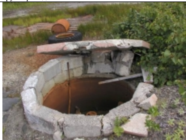
Рис 5 д. Разрушение верхней части колодца.
