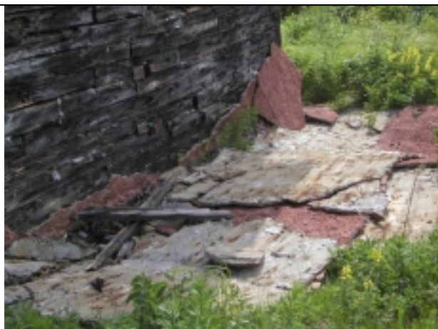
Рис. 3 е, ж, з. Обвалившаяся цементно-бетонная армированная «рубашка» деревянного дома.
