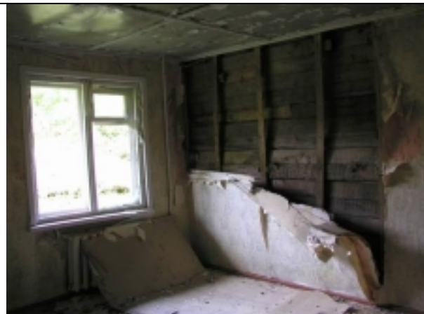
Рис. 3 р. Обрушение гипсокартонной облицовки во внутренних помещениях.
