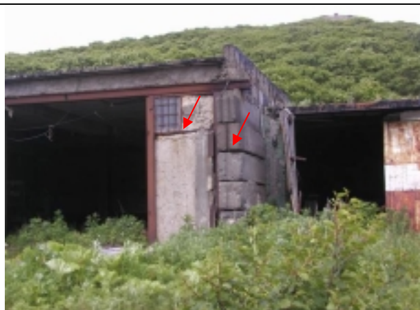
Рис. 4 ы. Трещины по стыкам бетонных блоков в гараже (№ 5 на рис. 3).
