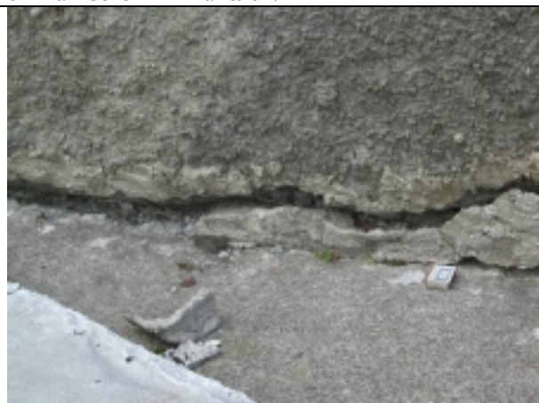
Рис. 4 ч. Трещина в фундаменте 4-этажного бетонного дома (№19 на рис.2).
