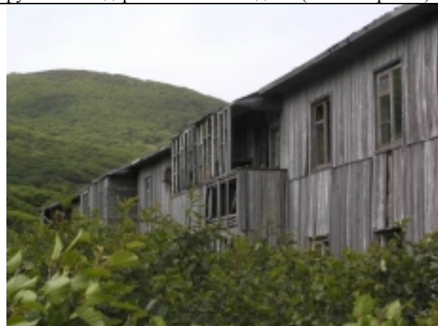
Рис. 3 п. Деформация деревянной обшивки стен дома.
