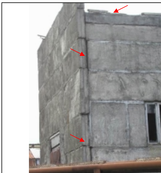
Рис. 4 а. Трещины по стыкам крупноблочного здания ДЭС, локальное обрушение бетонных козырьков на крыше (№22 на рис.2).
