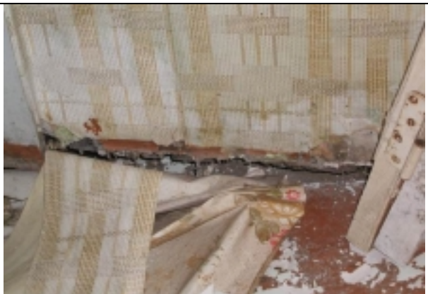
Рис. 3 к. Частичный провал пола, расхождение пола и стен в деревянных домах.
