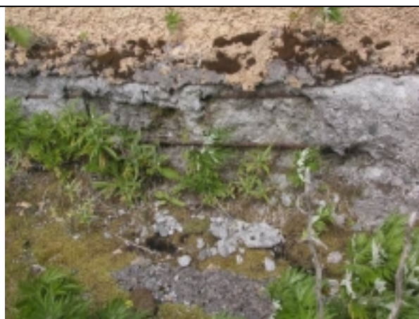
Рис. 3 д. Заливной армированный фундамент деревянного дома (№ 10 на рис. 2) местами выкрошился, но заметных нарушений в результате землетрясения не получил.
